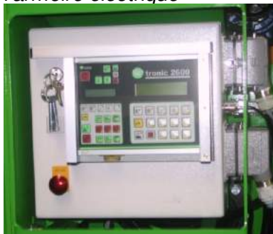
Bouton d'arrêt d'urgence sur l'armoire électrique
