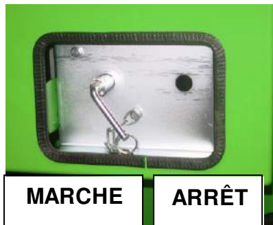
Interrupteur principal de la batterie
